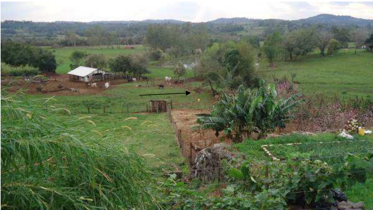
Figura 6.14 - Tubulação de deságue da rede do sistema de drenagem pluvial.
