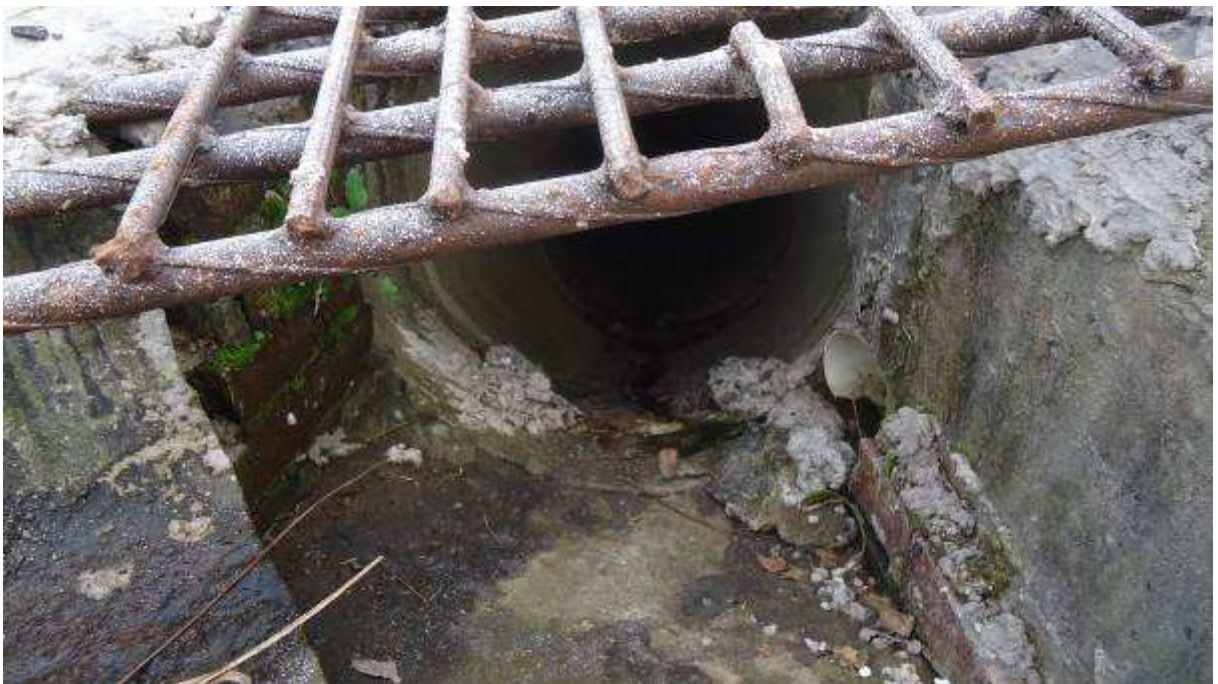
Figura 6.12 – Tubulação de drenagem junto a rua Argentina com Marquês do Herval.
